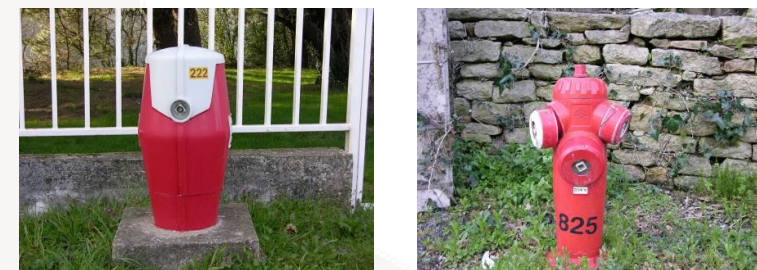
Exemples de numérotation de poteaux incendie
